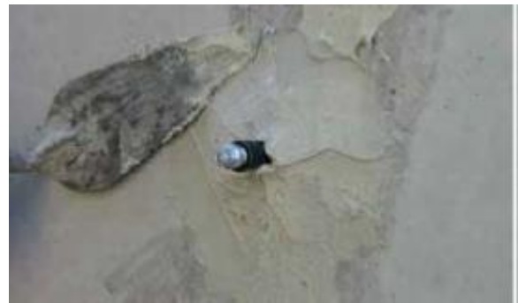
Рисунок 2. Герметизация пакера, установленного на поверхности и трещины при использовании соответствующего состава MasterFlow®.
