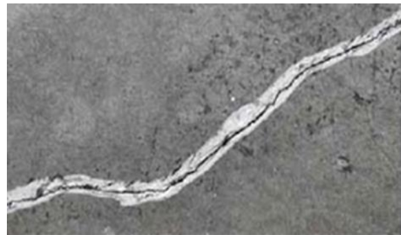
Рисунок 3. V-образная канавка вдоль трещины
