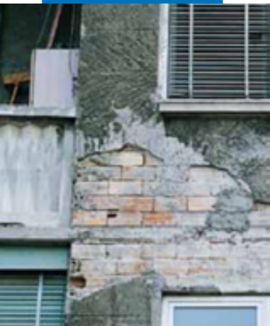
Рузрушающийся фасад здания, требующий ремонта
