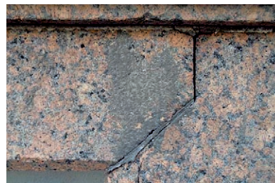
Дефекты швов гранитной облицовки цоколя. Санкт-Петербург, Мариинский театр
