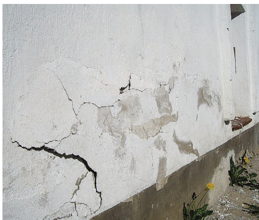
Деструкция известковой штукатурки в зоне цоколя Валаам, келья внутреннего каре, 2013 г.
