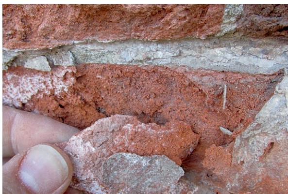
Разупрочненный кирпич, необходима обработка «РУНИТ Камнеукрепителем»
