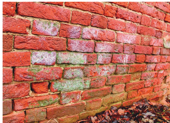
Сильно засоленная кладка, без отмостки г. Павловск, Санкт-Петербург, руины казармы Образцового Кавалерийского полка
