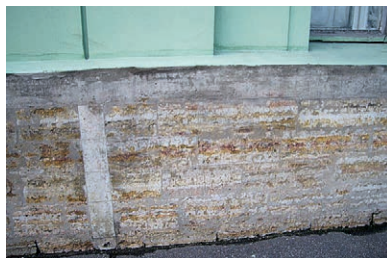
Дефекты облицовки цоколя из известняка. Санкт-Петербург, Мариинский театр
