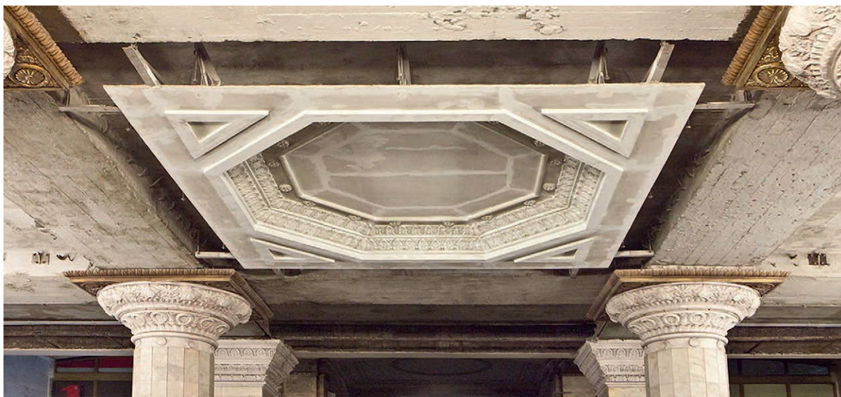
Элементы подвесного потолка, изготовленные из стеклофибробетона методом пневмонабрызга. Санкт-Петербург, вестибюль станции метро «Автово»
