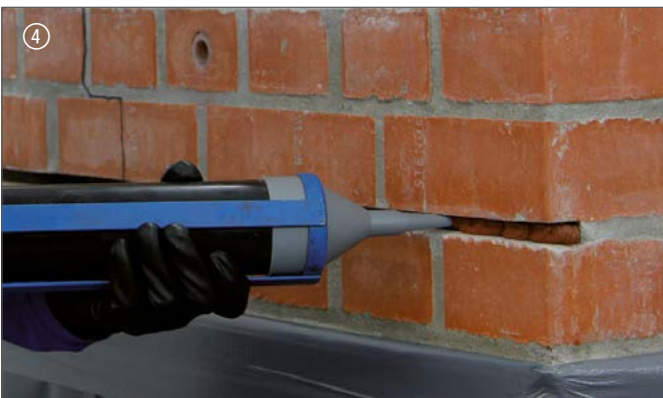
4 Erste Lage DESOI Spiralanker einbringen | Insert first layer of DESOI spiral anchor
