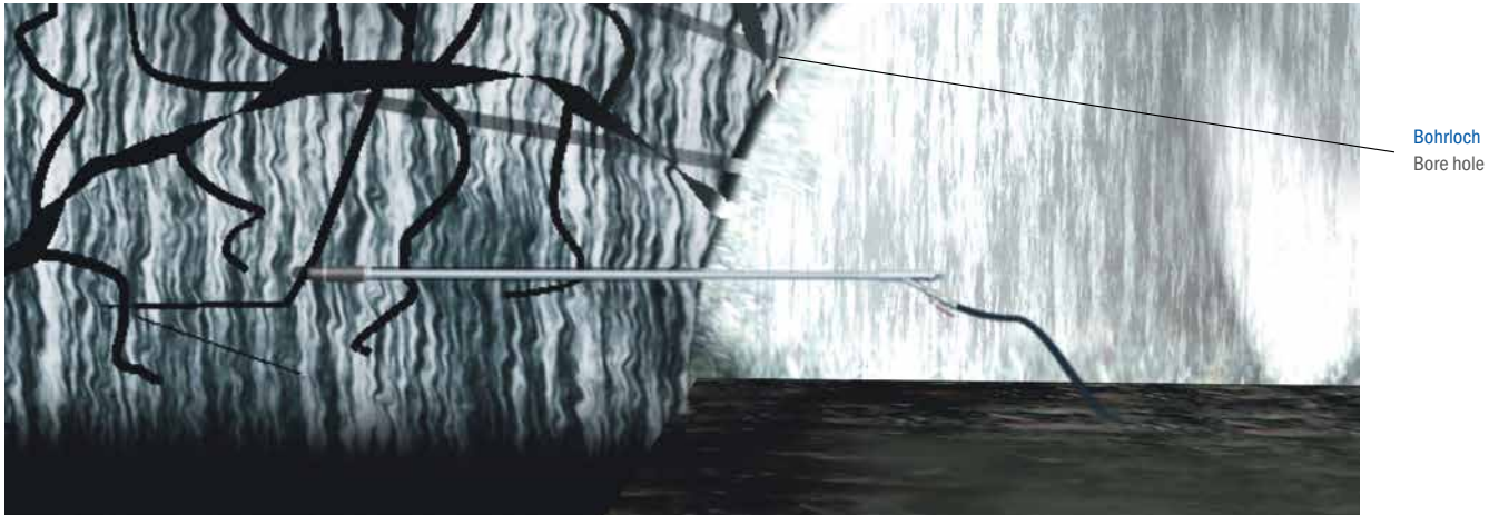
Spannpacker positionieren und mit der Spann- und Injektionsvorrichtung verspannen Place clamping packer and fix it using the clamping and injection device
