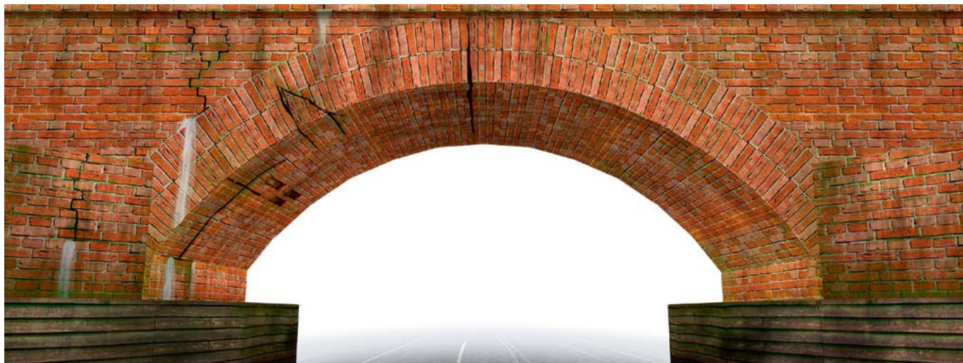
Risse im homogenen Mauerwerk - Sanierung mit mineralischen Füllstoffen | Cracks in homogeneous masonry - restoration with mineral filling materials
